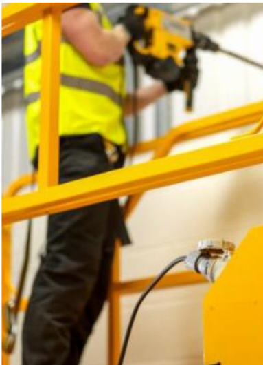
Tomada elétrica na plataforma
